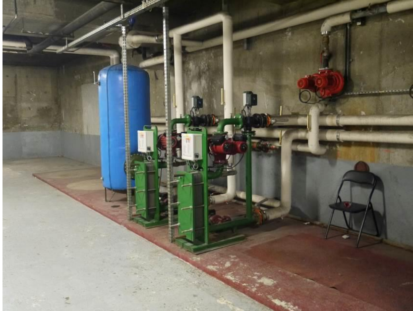
Photo de la production ECS pour les bâtiments A, B (zone basse) et C :
